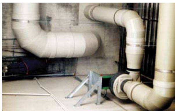
Труби промислової вентиляції
