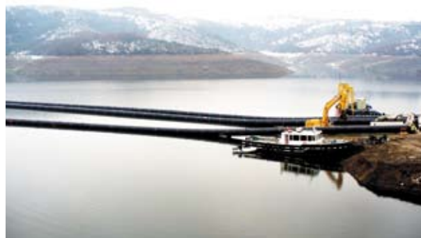
Трубопровід морського водовипуску DN/ID 1800 мм
